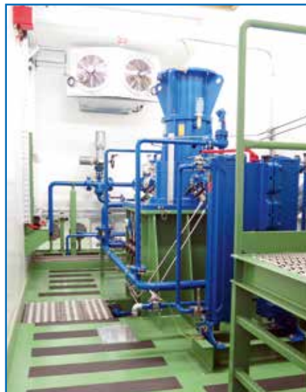
■ APOLLO-Hochdruckeinspritzpumpen-Skid mit vertikaler Topfpumpe
