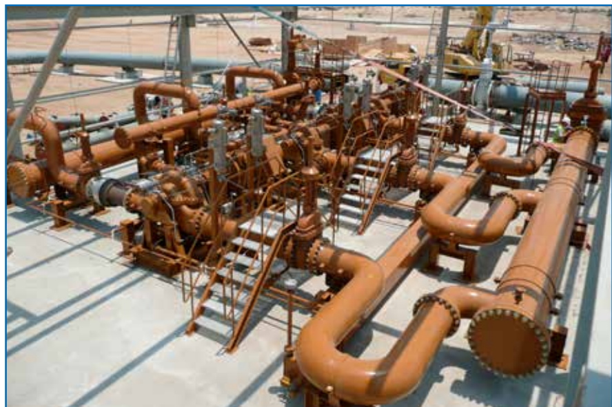
■ Booster-Station für die Entladung von Tankerschiffen
